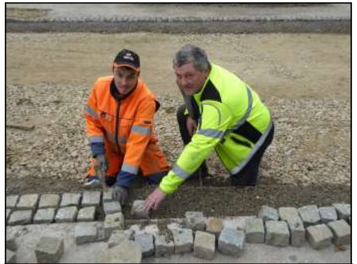
Die Fahrbahn wird mit Kleinschlagsteinen optisch eingegrenzt, Thomas Spiegl und Manfred Brandstetter beim Versetzen des Kleinschlages.
