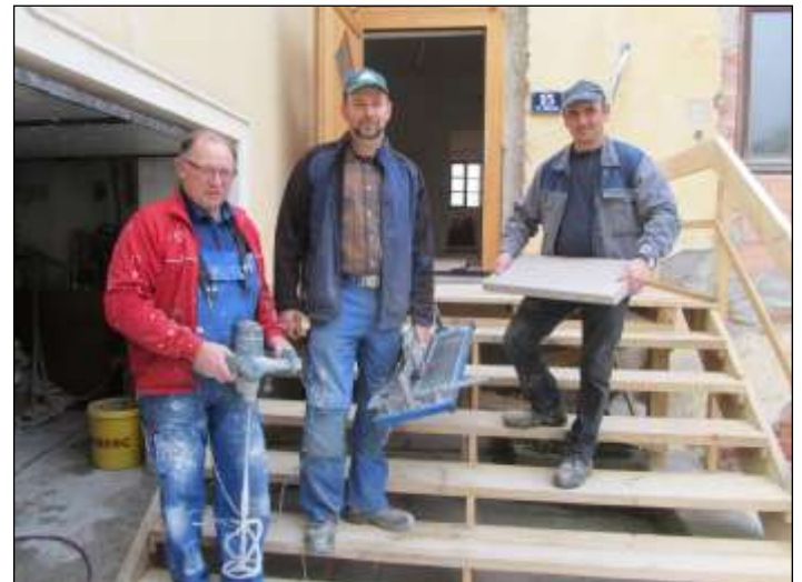
Martin Unterweger und Johannes Fasching legten bei den Bodenfliesen Hand an, unser ehrenamtlicher Bauleiter Josef Schmidt scheute keine Arbeiten.
