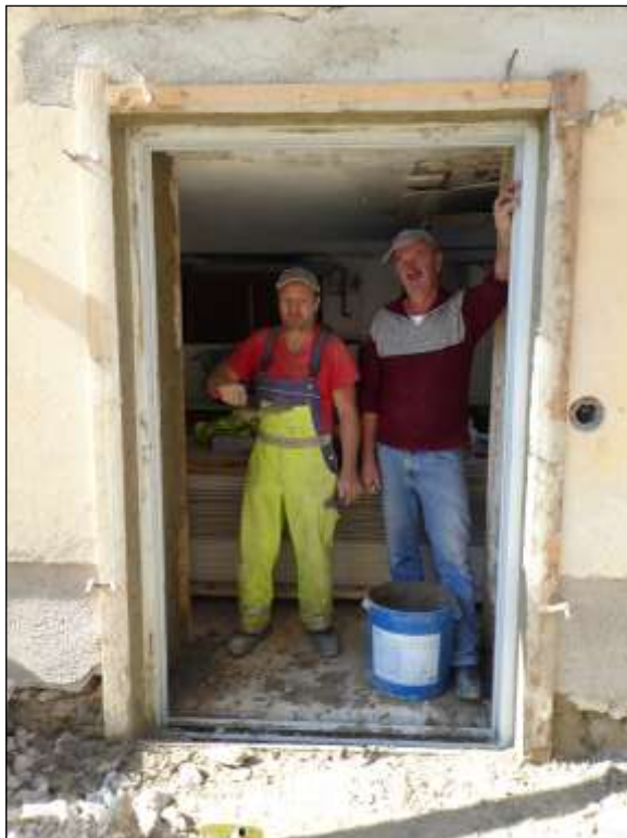
Leopold Fasching und Stephan Haider mauerten die neue Tür für den Außenlagerraum ein.
