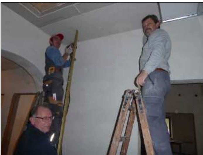
Manfred Käferböck (l.) und Richard Fischer wurden bei den Trockenbauarbeiten auch von Bauleiter Josef Schmidt unterstützt.
