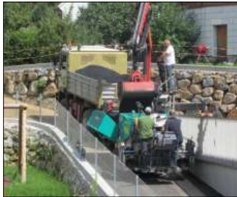
Das Foto zeigt die Arbeit für den Feinasphalt im Bereich der Rampe.
