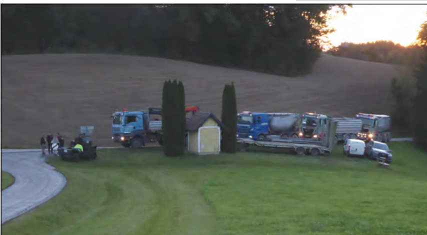
Straßenarbeiten brauchen das Verständnis der Anrainer, so wie hier am Sattl bei der „Haider-Kapelle“ kurz vor Beginn der Asphaltierungsarbeiten. Danke, dass dies im Regelfall so wie hier bestens funktioniert.
