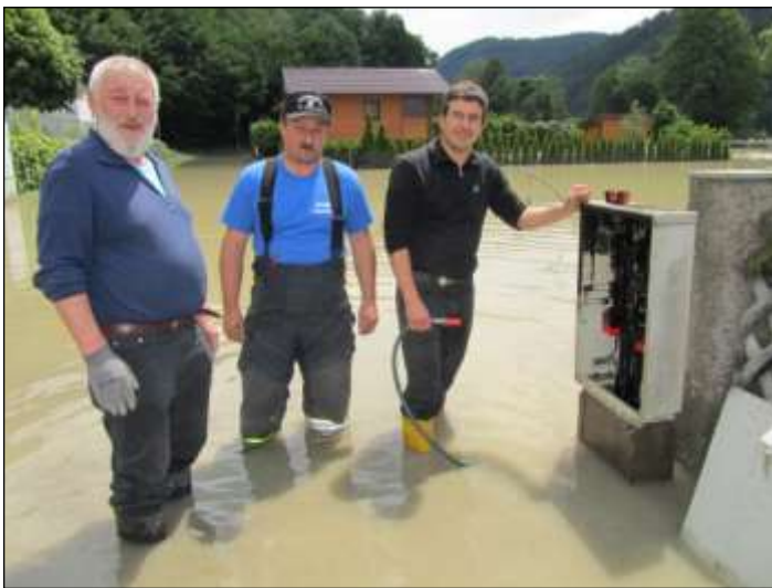
Mitarbeiter der Linz AG bemühten sich, sobald es irgendwie möglich war, die Stromversorgung in Hirschenau West wieder herzustellen.
