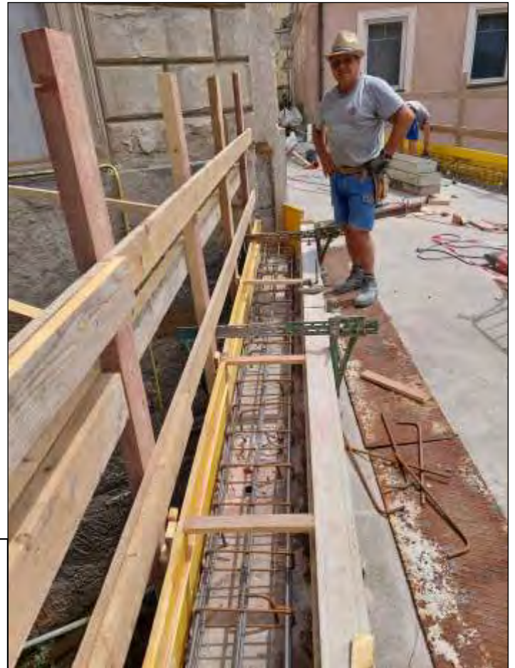
Das Foto zeigt Vorarbeiter Franz Reisinger bei der fertigen Schalung für das Schrammbord auf der Nordseite.
