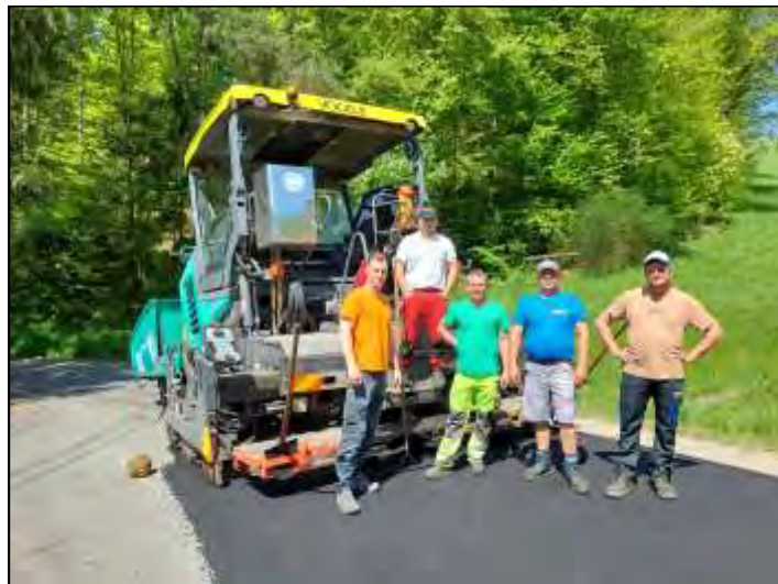
Das Foto zeigt die Mitarbeiter der Firma Malaschofsky vor dem Fertiger mit Parteileiter Michael Malaschofsky (r.) und Rafael Neuhauser (l.) vom WEV.
