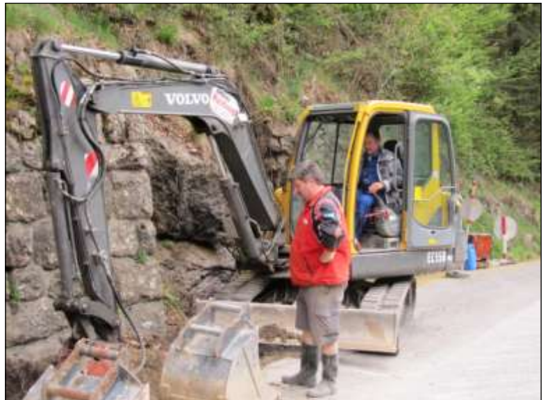
Wasserwart Manfred Brandstetter beobachtet das Freilegen der Leitung von Baggerunternehmer Johann Haidvogel.
